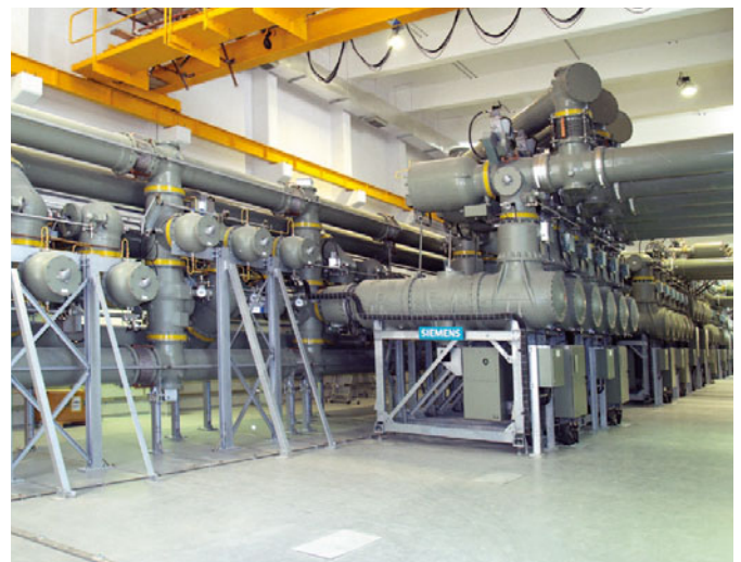
Figura 3.1-39: Aparamenta 8DQ1 para una tensión nominal de 550 kV
