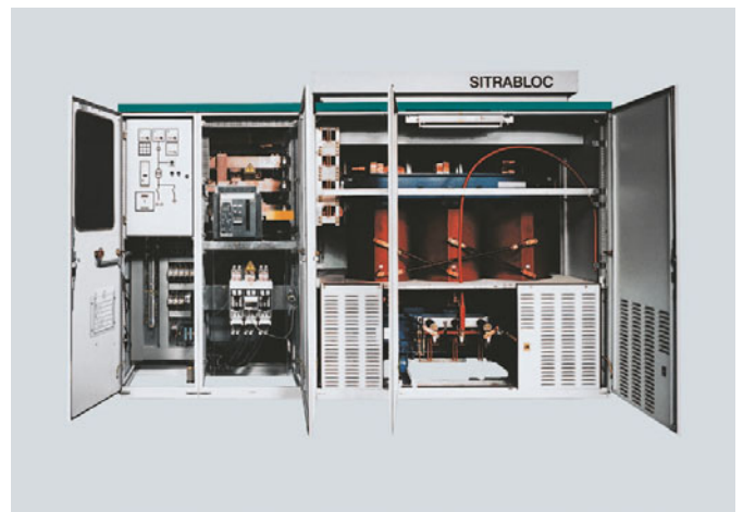
Figura 3.2-43: Transformador y seccionador de puesta a tierra, bloque BT
