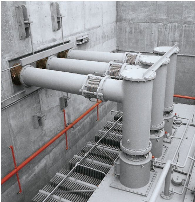
Figura 3.1-48: Módulos de terminación de transformadores
