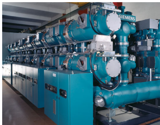
Figura 3.1-37: Aparamenta 8DN9 para una tensión nominal de 245 kV, con embarrado pasivo encapsulado trifásico
