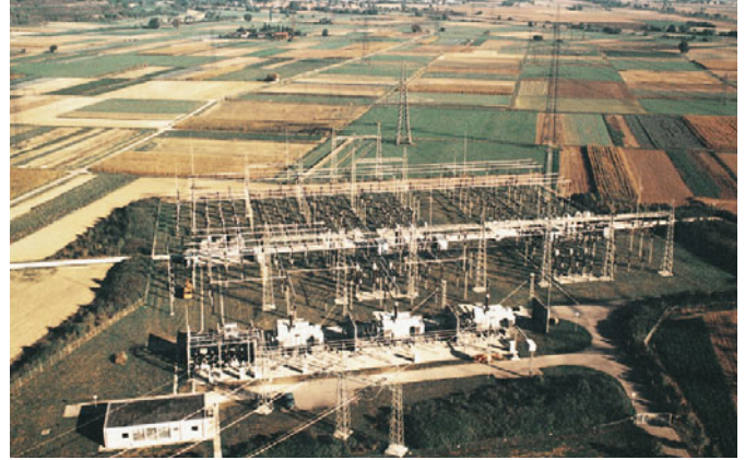
Figura 3.1-2: Aparamenta exterior aislada en aire
