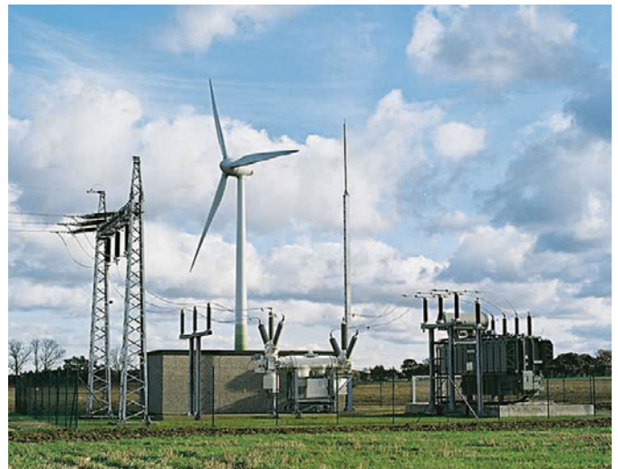
Figura 3.1-35: 8DN8 HIS para tensión nominal de 145 kV para eólica terrestre acceso de energía al sistema
