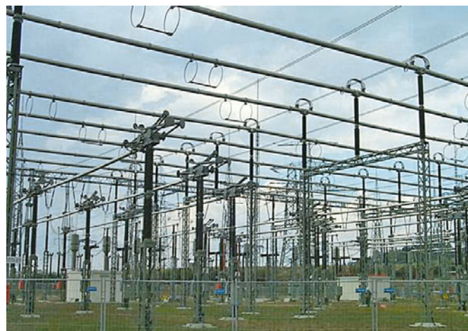
Figura 3.1-20: Seccionadores de barras en disposición diagonal, 380 kV, Alemania
