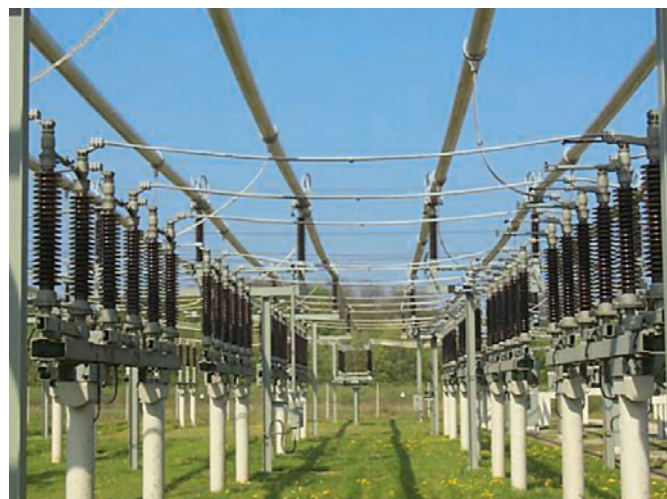
Figura 3.1-16: Seccionadores de barras "en línea", 110 kV, Alemania
